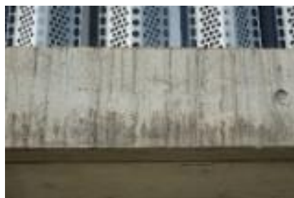
写真 - 庇 (クラック)
