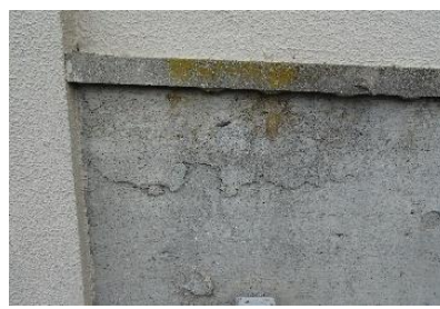
写真 - 基礎 (クラック)
