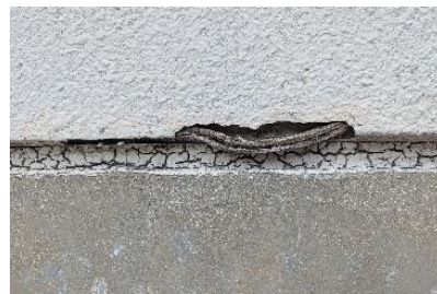
写真 - 外壁 (破損)
