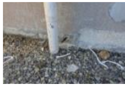
写真 - 基礎 (爆裂)
