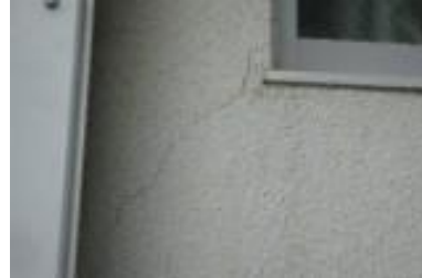
写真 - 外壁 (クラック)
