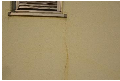
写真 - 外壁 (クラック)
