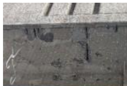
写真 - 上階バルコニー (爆裂)
