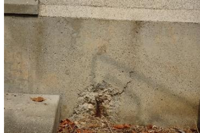
写真 - 基礎 (爆裂)
