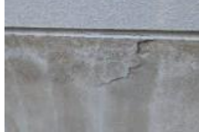
写真 - 基礎 (爆裂)
