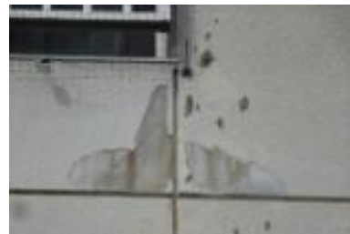
写真 - 外壁 (クラック塗装剥離)
