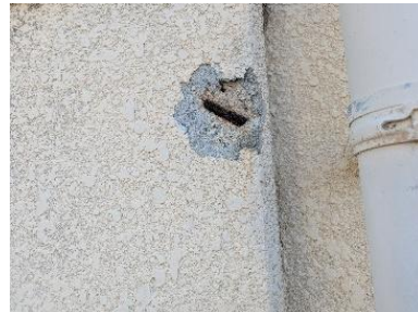
写真 - 外壁 (爆裂)
