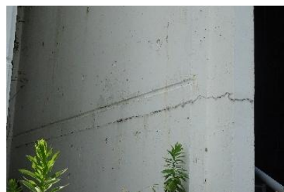
写真 - 外壁 (クラック)
