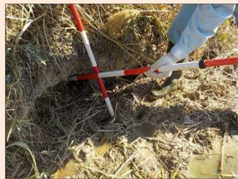
獣害の進行による陥没 (S-3～S-2 程度)
