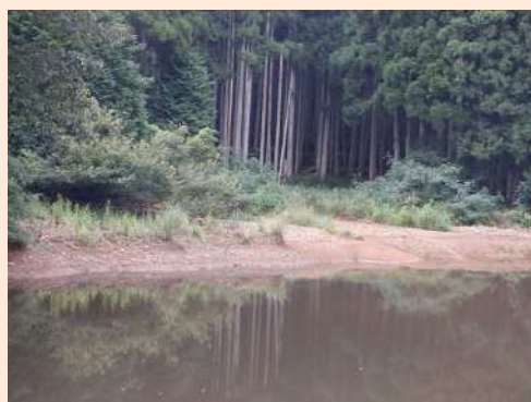
土砂堆積状況
