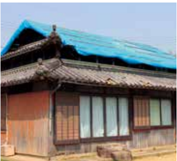
▲地震で屋根瓦が崩れた住宅
