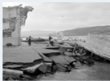
▲被災した護岸
