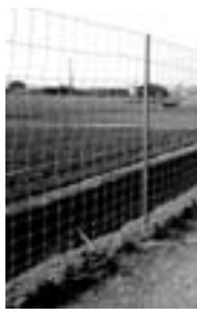
▲設置された防止柵
