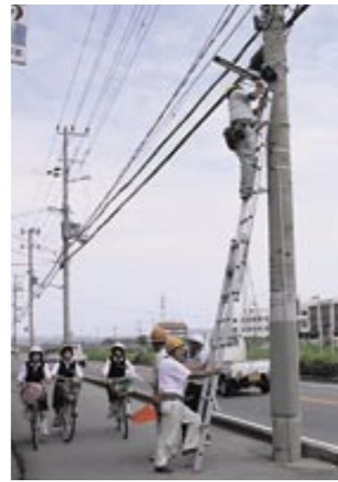
▲中学校周辺の通学路にある防犯灯の点検・清掃を行いました
