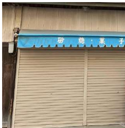
下屋下のロールテント
