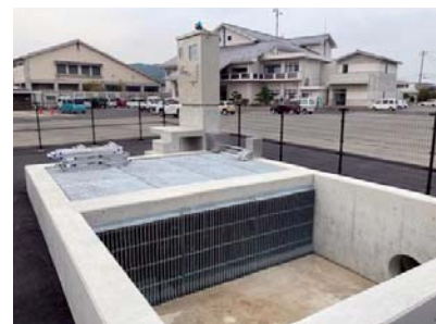
▲西淡庁舎前排水ポンプ
