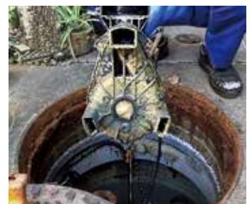
中央の管がシートで詰まった排水設備
