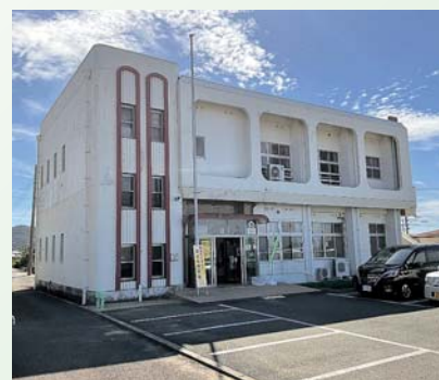
▲改修が急がれる神代公民館
