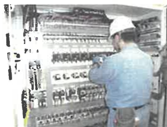
◆緊急出動動力盤点検
