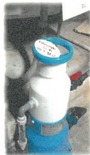
南あわじ機械室内
