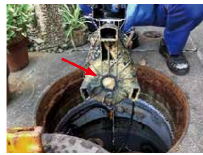
中央の管がシートで閉塞した排水設備
