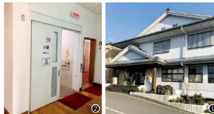
①雨漏りを修繕した淡路人形浄瑠璃資料館・中央公民館図書室 ②自動扉を修繕した多目的トイレ
