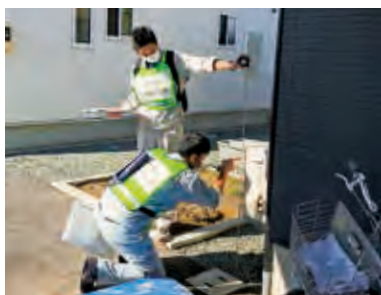
家屋被害を調査する職員ら
