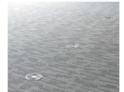
天井の高い1階は居住域を効率的に空調する床噴出し方式を採用
