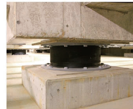
免震構造の採用による震災直後からの拠点機能を維持
