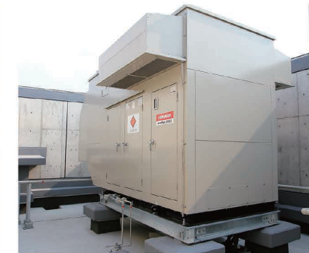
「官庁施設の総合耐震計画基準及び同解説」に準拠した72時間のバックアップ可能な非常用エンジン
