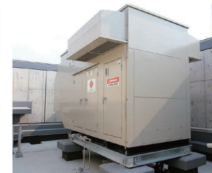
「官庁施設の総合耐震計画基準及び同解説」に準拠した72時間のバックアップ可能な非常用エンジン
