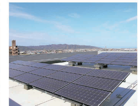
太陽光パネル設置、電力使用量の見える化などエネルギーのランニングコスト削減
