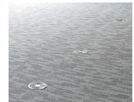
天井の高い1階は居住域を効率的に空調する床噴出し方式を採用
