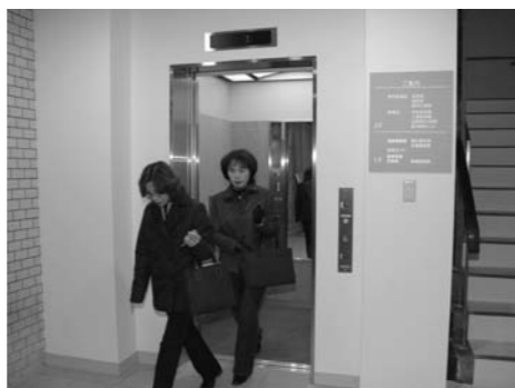
西淡第二庁舎に設置されたエレベーター
