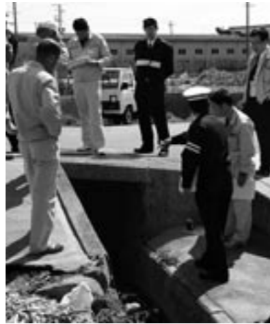
▲小学校近くの道路脇の落差約1.5mの溝。危険かどうかを点検する参加者
