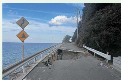
▲陥没した県道
