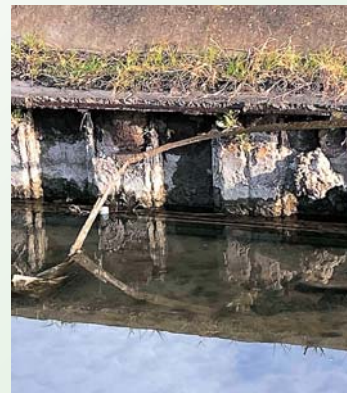
▲内入貫川の損傷した矢板
